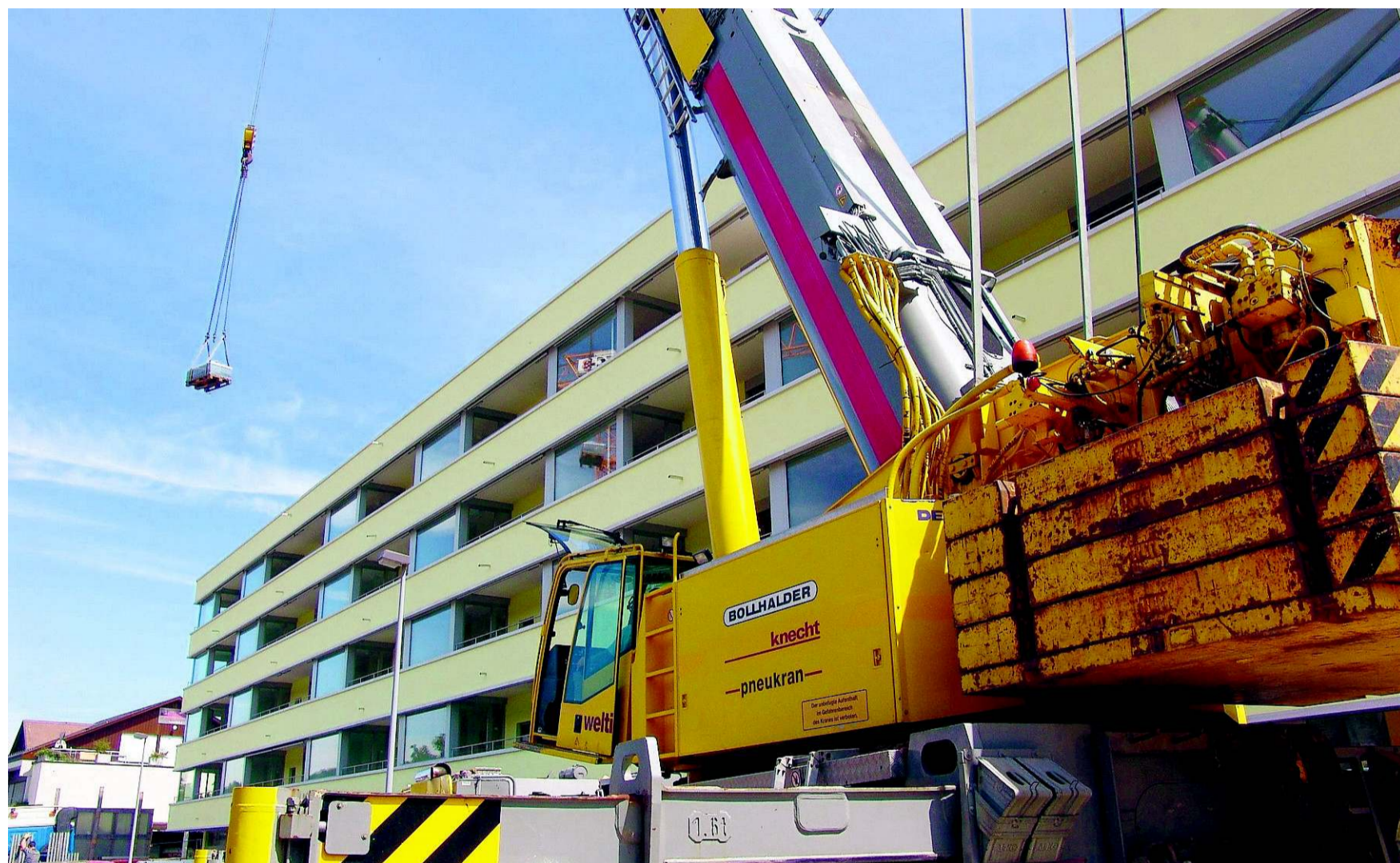
Die verschiedenen Elemente werden mit dem Pneukran über die neu erbauten Alterswohnungen gehievt.
